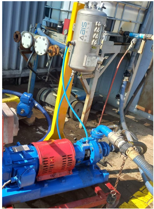
Unidad de lubricación instalada en planta química.
