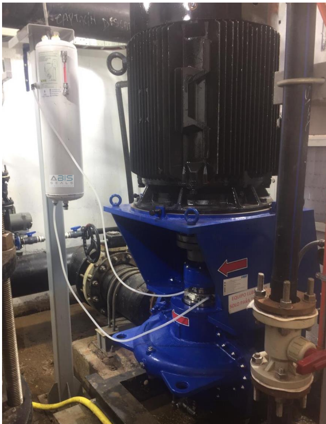
Reservorio instalado en Minera al norte de Chile
